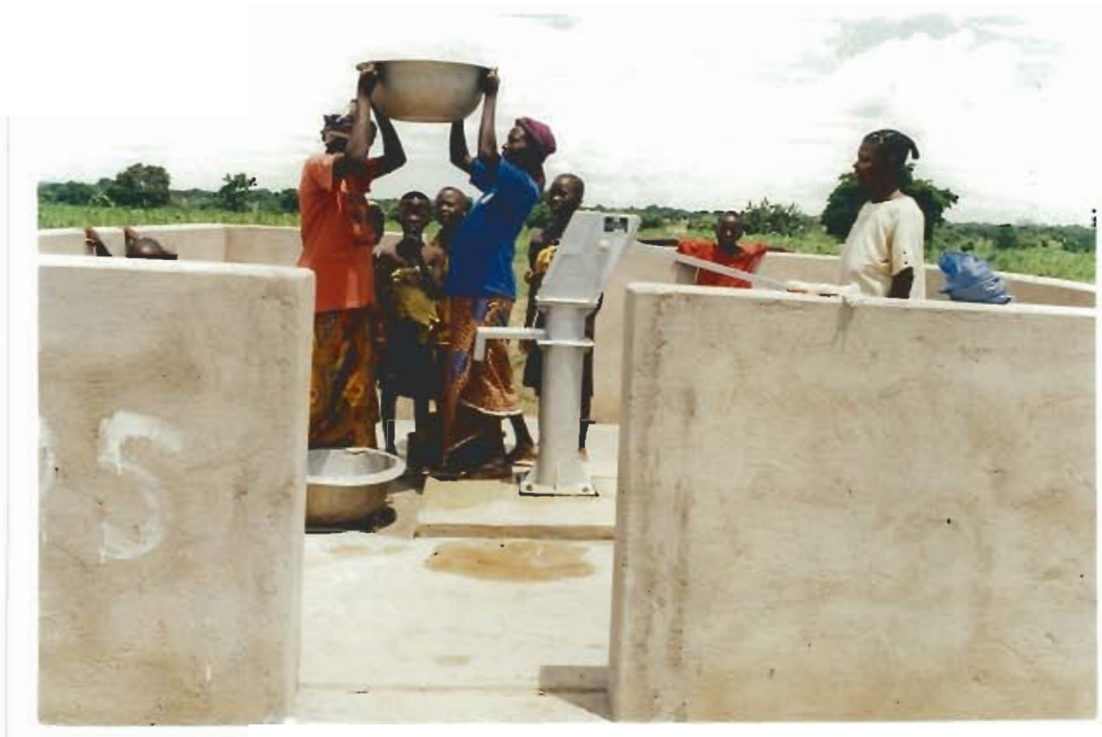
Pompe de marque India fixée au centre.
