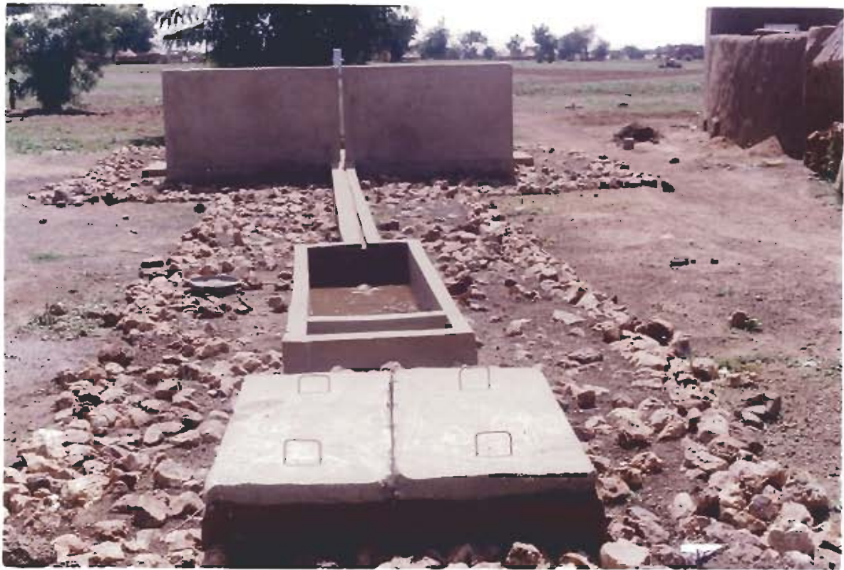
Vue générale du forage de Kobouré (Dassui) (une superstructure bien aménagée).
